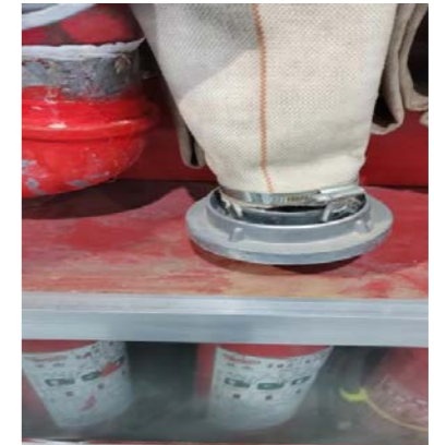
消防水带破损
